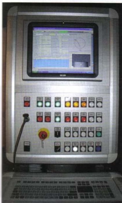
Painel de controle diretamente na estação de fresagem
