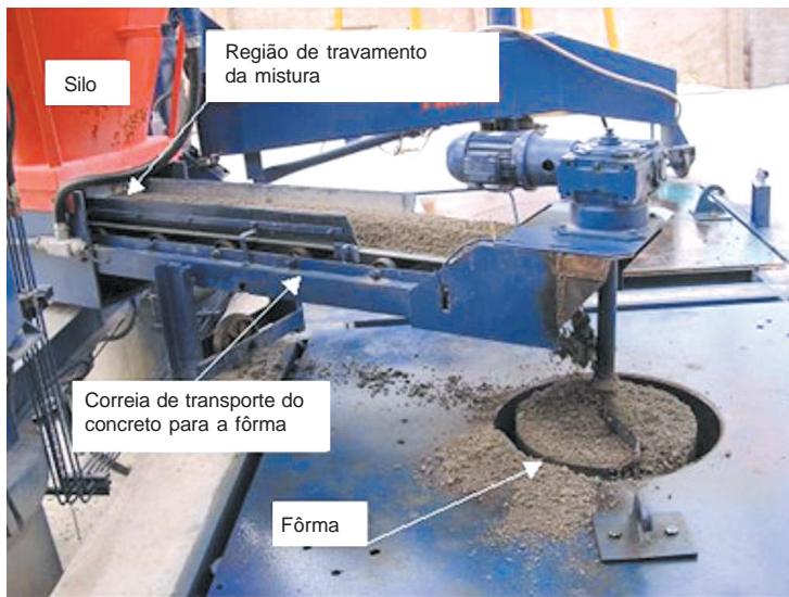
FIGURA 5.56 - Situação em que houve bloqueio da movimentação da mistura destinada à moldagem de um tubo de concreto devido a adição de elevado teor de fibras sem ajuste do traço da mistura
