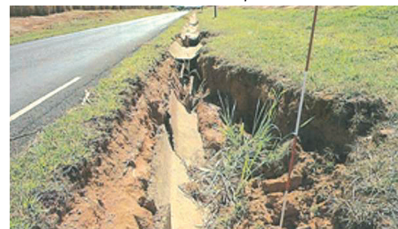
FIGURA 11.9 - Velocidade Excessiva de Água
