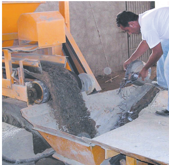
FIGURA 5.58 - Lançamento de fibras coladas na correia transportadora de agregados para a betoneira
