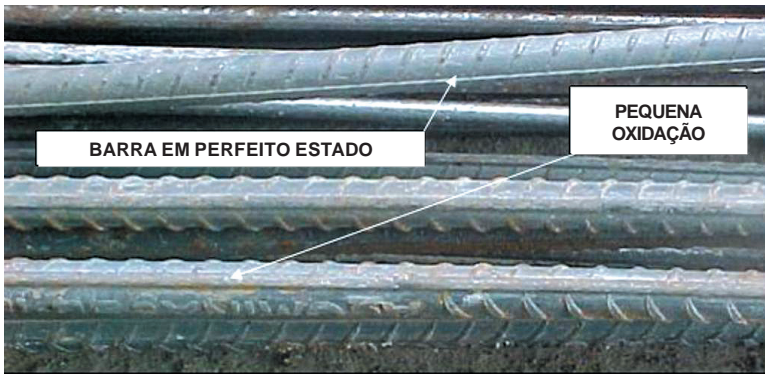
FIGURA 5.29 - Oxidação leve em barras de aço para concreto armado
