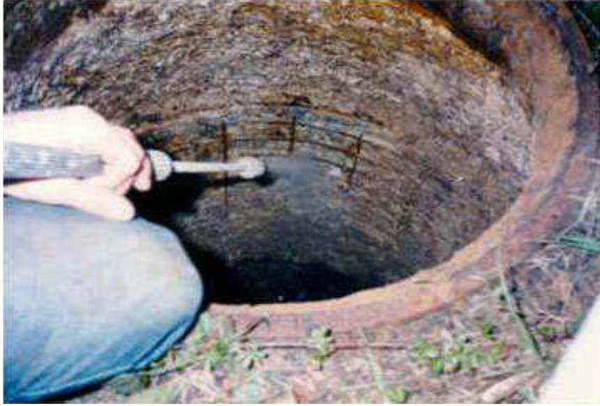
Poço de concreto muito afetado pela corrosão MIC: após a eliminação do gesso que recobre as paredes interiores dá para ver que a corrosão eliminou todo o revestimento e as armaduras ficaram expostas. O ácido sulfúrico corroeu tanto concreto como aço.
